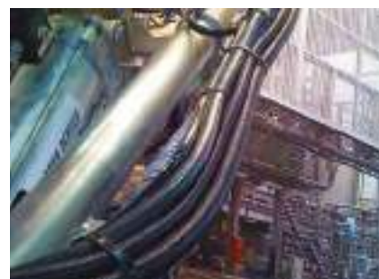
Impianti industriali Industrial plants
