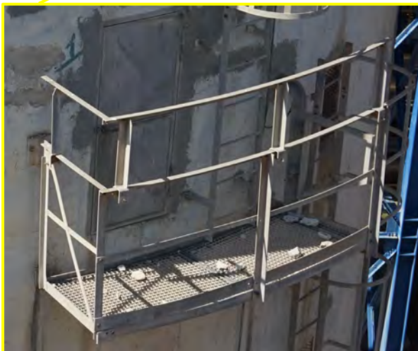
Frammenti di cls su pianerottolo di riposo alla quota 15,10mt
