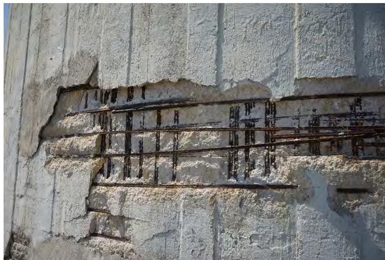
Tipologia ammaloramenti significativi tra la quota +32,00mt e la quota +43,00mt
