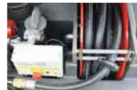
Il quadro elettrico e l'arrotolatore. Electric switchboard and spring rewind hose reel.
