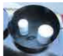
Red escurrefiltros interna. Rede de drenagem de filtros interna.
