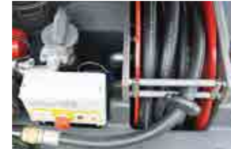
Cuadro eléctrico y enrollador de manguera. Placa de interruptores elétricos e carretel da mangueira.
