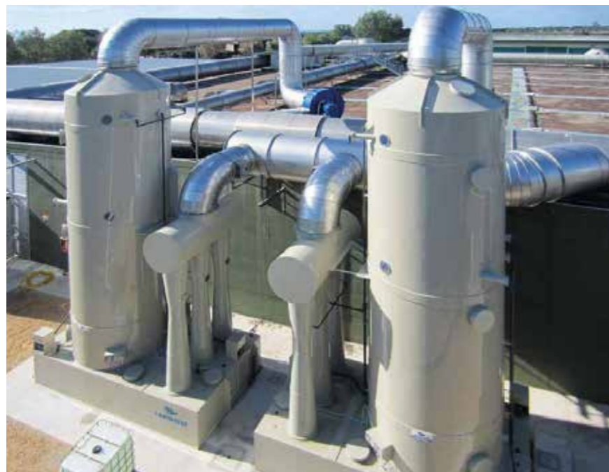
2 Scrubbers da 50.000 Nm 3 /h
