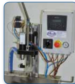
Quadro elettrico con PLC Panneau électrique avec PLC Electric panel with PLC
