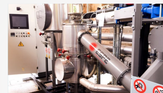
Impianto di Cogenerazione a Biomassa da 50 kWe/110 kWt
