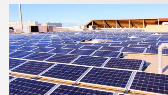
Impianto Fotovoltaico da 350 kWe
