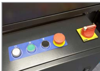
PANNELLO DI CONTROLLO CONTROL PANEL
