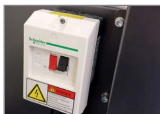
INTERRUTTORE GENERALE MAIN POWER SWITCH
